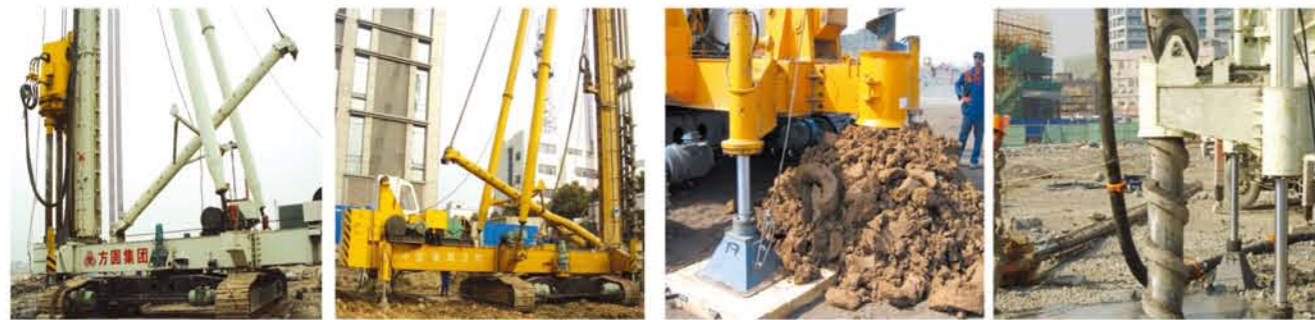
JZL120电动履带式桩机 南京奥体中心工地 SPR650多轴钻机 苏州工地 JZL60电动履带式桩机 哈萨克斯坦工地 JZW90电动履带式螺旋桩机 上海工地
